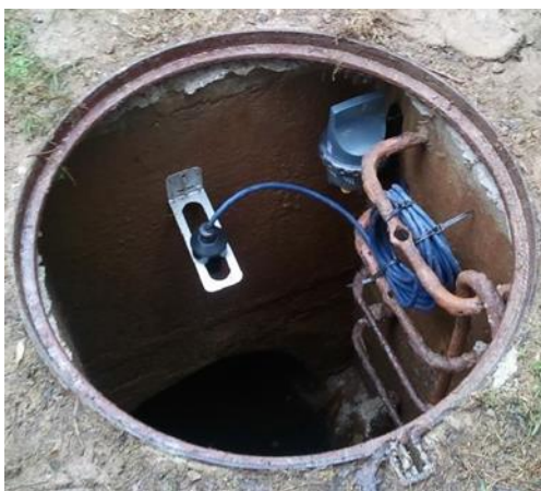
Рисунок 3 - Пример монтажа АП в колодце
